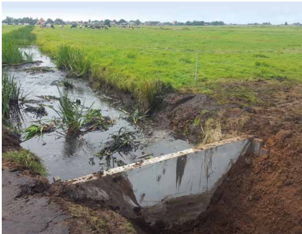
Een strekdams geplaatst voor het opzetten van hoogwaterpeil.
